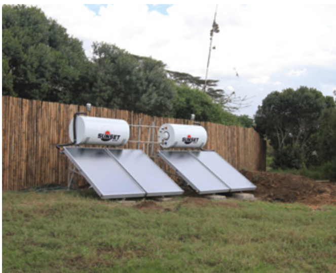
Solare Wasserversorgung im gesamten Zeltcamp: Das Ringleitungssystem geht über knapp zwei Kilometer. – Solar water supply for the entire bush camp: the circular pipeline system extends for almost two kilometres.
