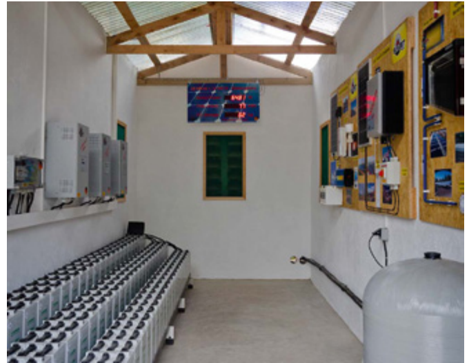
Eine Dauerausstellung im Batterieraum veranschaulicht die Vorteile von Erneuerbare-Energien-Technologien. – A permanent exhibition in the battery room illustrates the benefits of renewable energy technologies.
